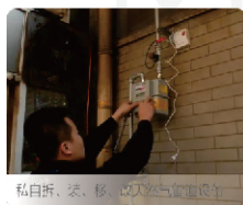
私自拆、装、移、改天然气管道设备
